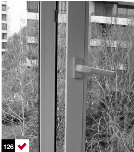
Foto 126: cerrajería que permite un buen apoyo de mano para efectuar las maniobras de apertura o cierre.
